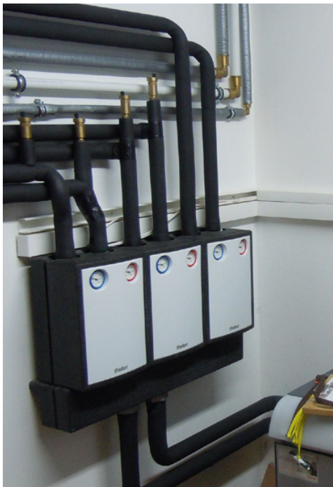
Slika 1. Kućni razvod – središnji kolektor
