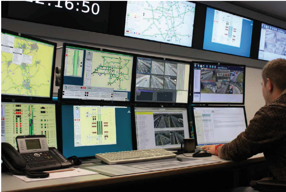
Slika 2. Unutrašnjost COKP-a s prometnom stanicom i pregledom kamera
